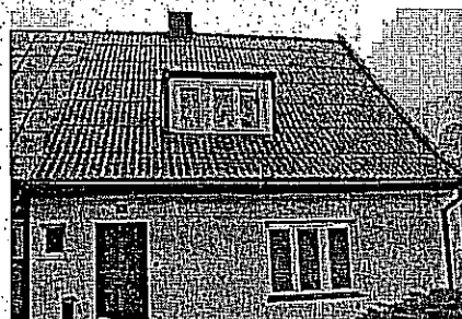
Rys. 6. Pokrycie dachowe ocenione w III stopniu pilności.
